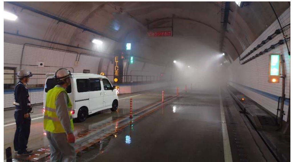
トンネル内で火の勢いを抑制する水噴霧設備の稼働点検の様子。
