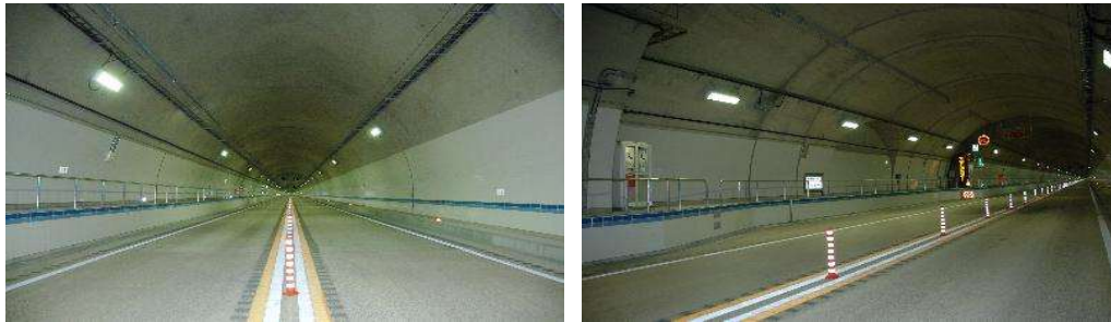
現在のトンネル照明
