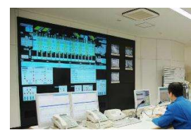
監視制御設備の更新
