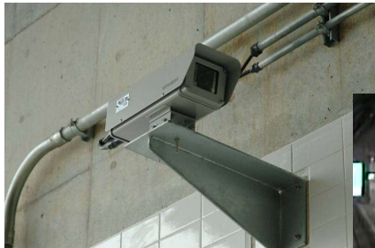
トンネル内監視カメラ
