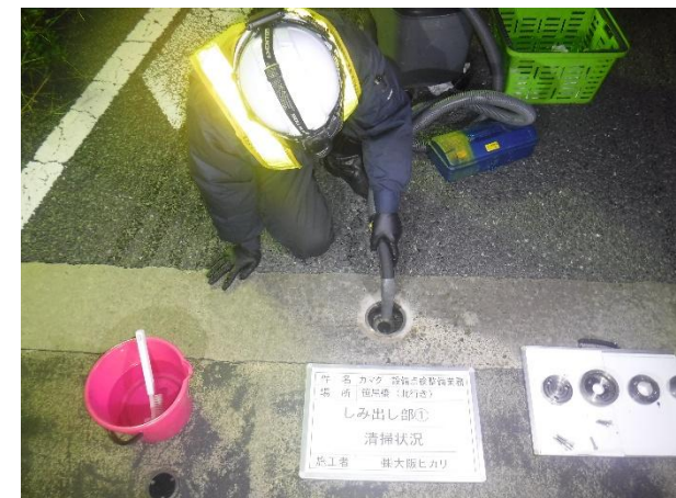
路面凍結防止設備点検
