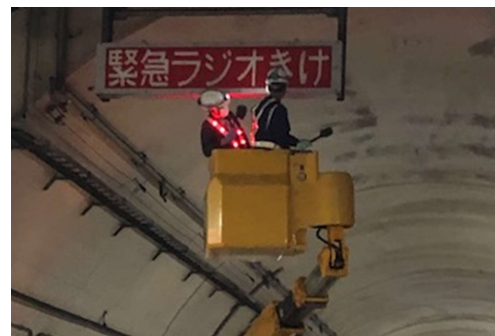
防災設備 点検作業中
