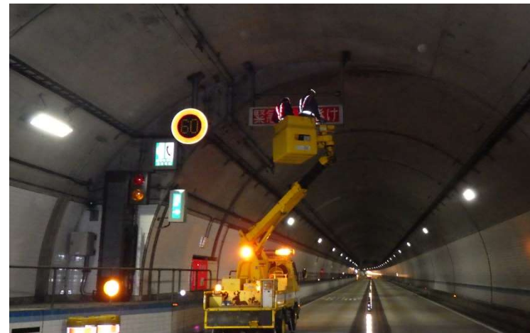
防災設備点検
