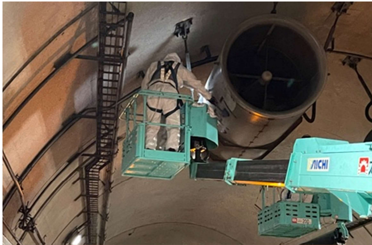
換気設備点検
