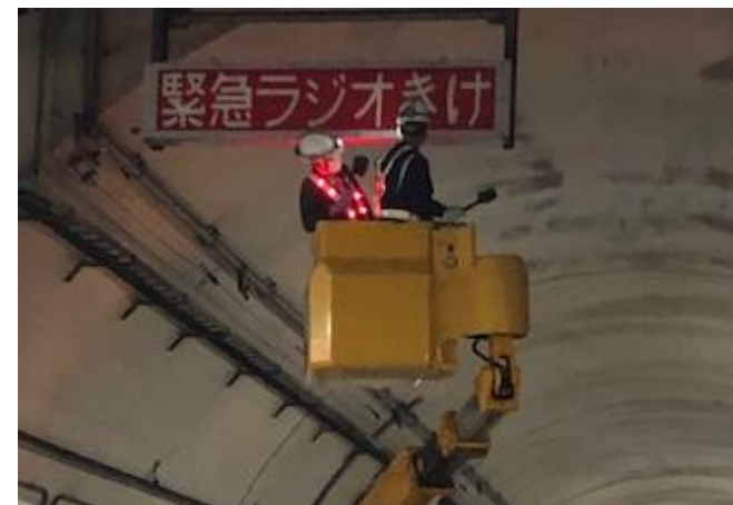
防災設備点検
